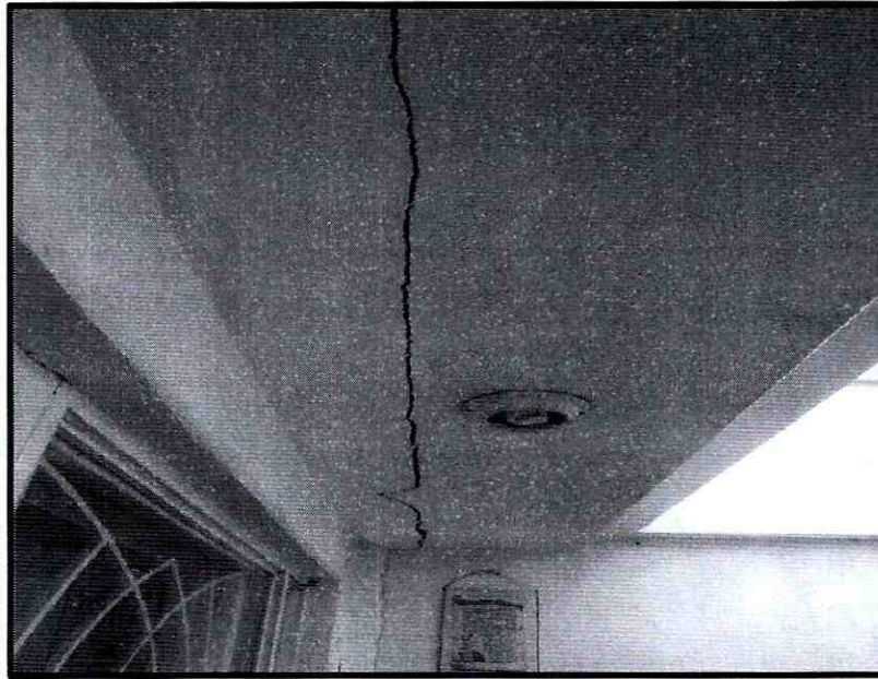
Fotografía 5. Fisura en la torta inferior del entepiso junto a la entrada en el predio de la Calle 85 A No 27-10
