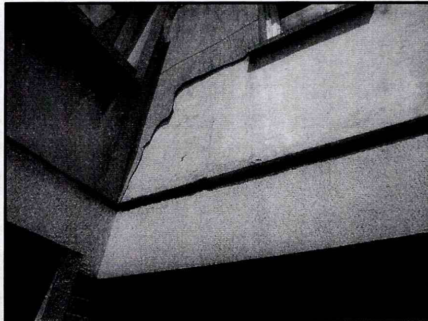
Fotografía 4. Desprendimiento de carrasplas en muro de cerramiento del segundo nivel en el predio de la Calle 85 A No 27-02
