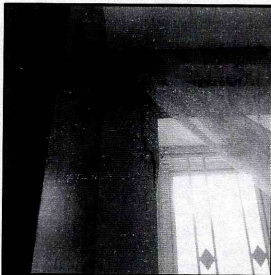
Fotografías 7 y 8. Desprendimientos de pañete y mampuestos en las mochetas que conforman la ventana de la alcoba principal en el predio de la Calle 85 A No 27-12
