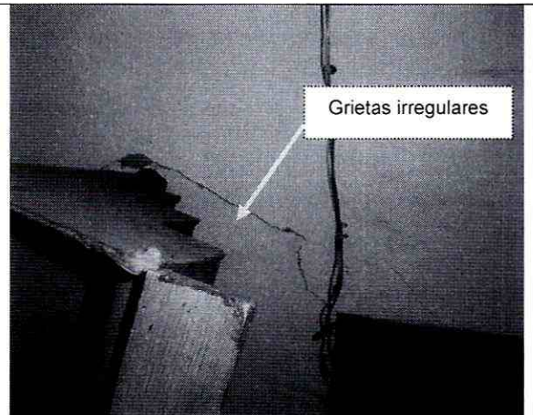
Fotografía 6. Vista de una fracción de muro interno del primer nivel de la edificación evaluada, donde se observa la presencia de grietas de tendencia irregular.
