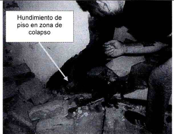
Fotografía 4. Vista del piso en la zona de colapso del muro en el primer nivel, donde se observa hundimientos en el piso.
