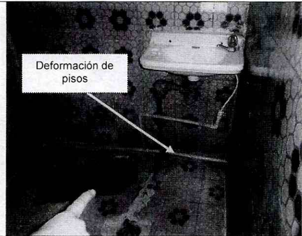
Fotografía 6. Vista de la placa de entpiso del segundo nivel en área de baño, por encima del muro colapsado, donde se observan deformaciones severas de la superficie de piso.
