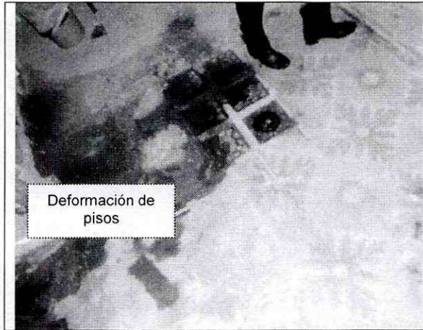
Fotografía 5. Vista de la placa de entpiso del segundo nivel en área de patio, por encima del muro colapsado, donde se observan deformaciones severas de la superficie de piso.
