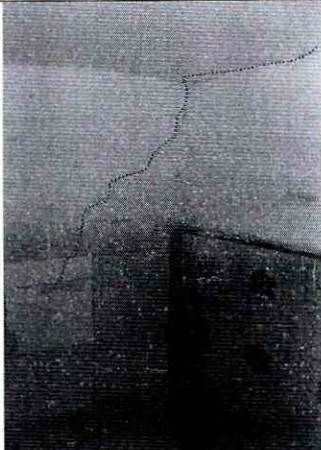
Foto No. 5. Vista fisuras en primer nivel
