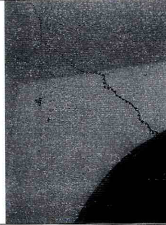
Foto No. 4. Vista de las fisuras del predio de la Carrera 68G No 65-68
