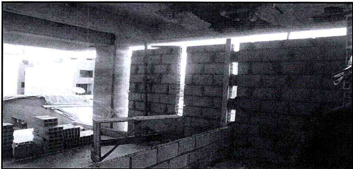
Fotografía 3. Muro levantado el 29 de Agosto de 2016 en la obra aledaña de la edificación evaluada, junto al muro que colapsó y que permanece en pie.
