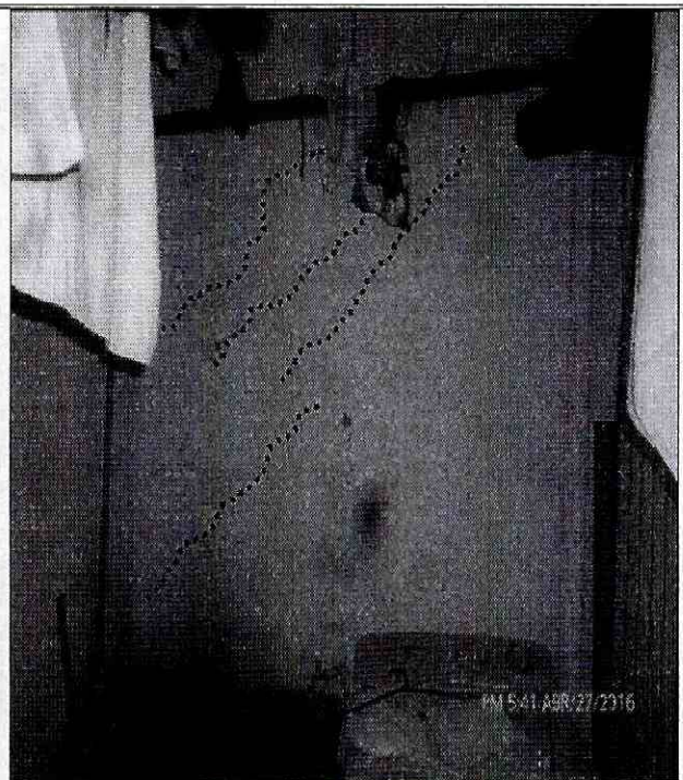
Fotografía 10. Fisuras identificadas en muros de cerramiento en las viviendas ubicadas en los predios de la Calle 139 A No. 108 A - 23 y la Calle 139 A No. 108 A - 27, en el Barrio las Flores de la Localidad Suba.
