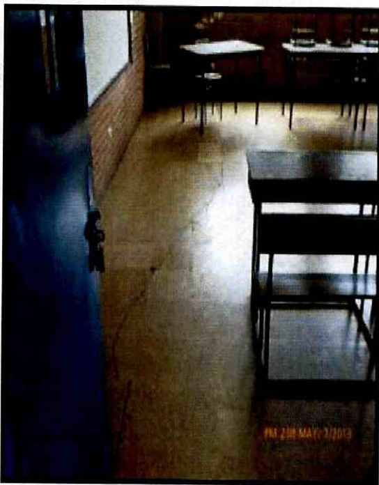
Fotografía 8. Grieta evidenciada en el acabado del contrapiso del salón del costado nor occidental del primer nivel, evidenciada en la vista del 7 de mayo de 2012 (RO-62704)
