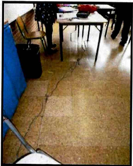
Fotografía 9. Grieta evidenciada en el acabado del contrapiso del salón del costado nor occidental del primer nivel, evidenciada en la vista del 22 de Agosto de 2016 (RO-62704)
