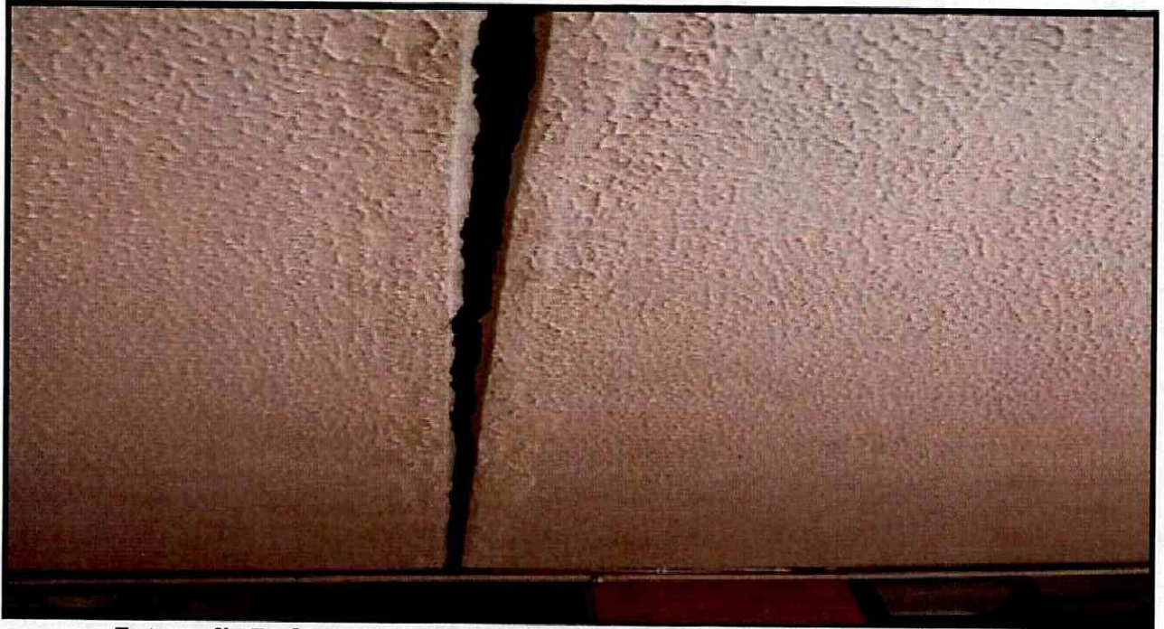
Fotografía 7. Separación entre las tortas inferiores de las placas en de entrepiso, enfrentadas entre los bloques central y norte, en el colegio Los Pinos, localizado en el predio de la Diagonal 4A No 5B-93 en barrio los Laches de la localidad de Santa Fe.
