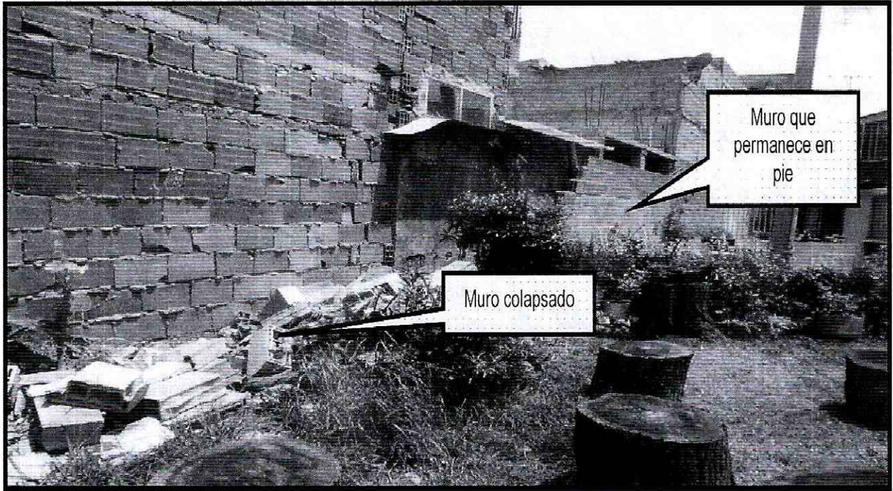
Fotografía 2. Muro de cerramiento del costado sur parcialmente colapsado, en el conjunto residencial “La agrupación de vivienda las casas etapas I, II, III y IV”
