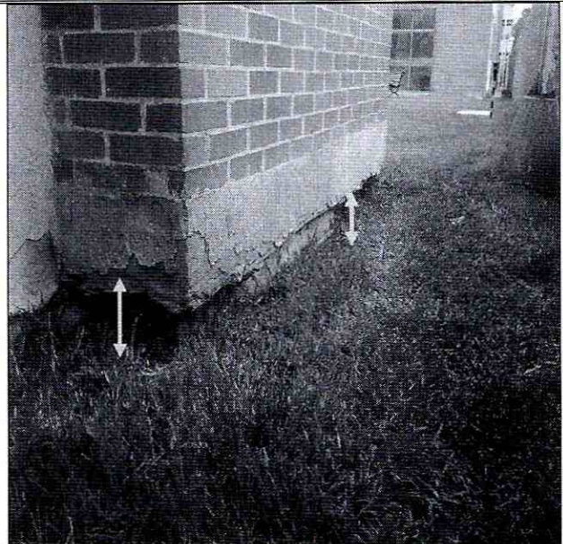
Fotografía 10. Hundimientos del terreno de la zona verde del costado oriental del Conjunto Residencial Senderos del Carmel 2.
