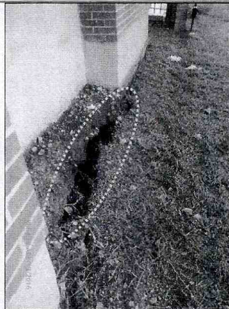
Fotografía 6. Aberturas en el terreno de la zona verde del costado occidental del Conjunto Residencial Senderos del Carmel.
