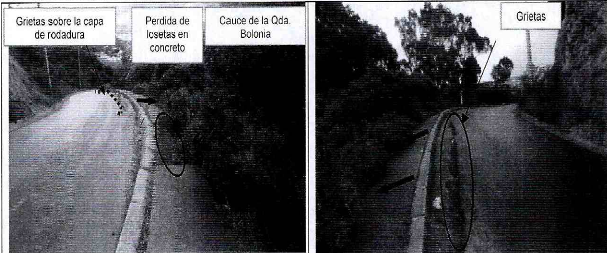
Fotografía 1. Vista de la Calle 81 B Sur, pérdida y deformación de placas en concreto del andén y el sardinel, costado norte de la vía.
