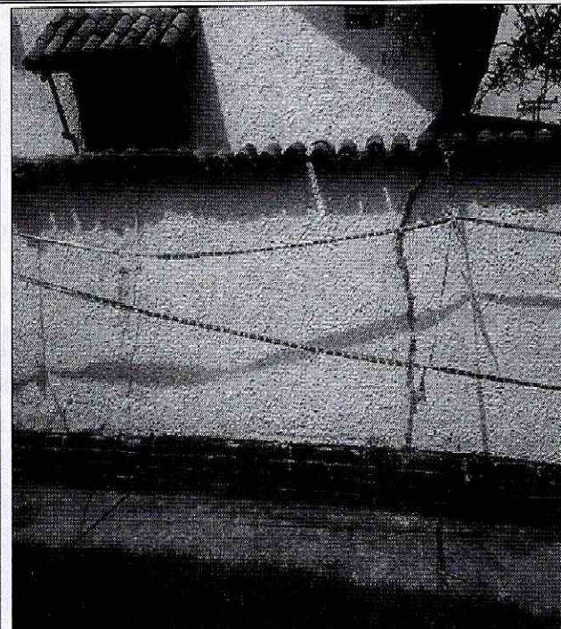
Fotografía 12. Fisuras y grietas en el muro de de cerramiento con pérdida de verticalidad ubicado al costado occidental de la zona de jardín de la vivienda ubicada en el predio de la Calle 104 No. 58 A – 22, en el Sector Catastral Puente Largo de la Localidad Suba.
