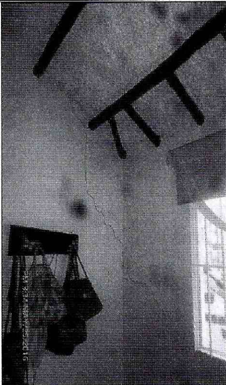
Fotografía 5. Grietas identificadas en muros de cerramiento y divisorios de la vivienda ubicada en el predio de la Calle 104 No. 58 A – 12, en el Sector Catastral Puente Largo de la Localidad Suba.
