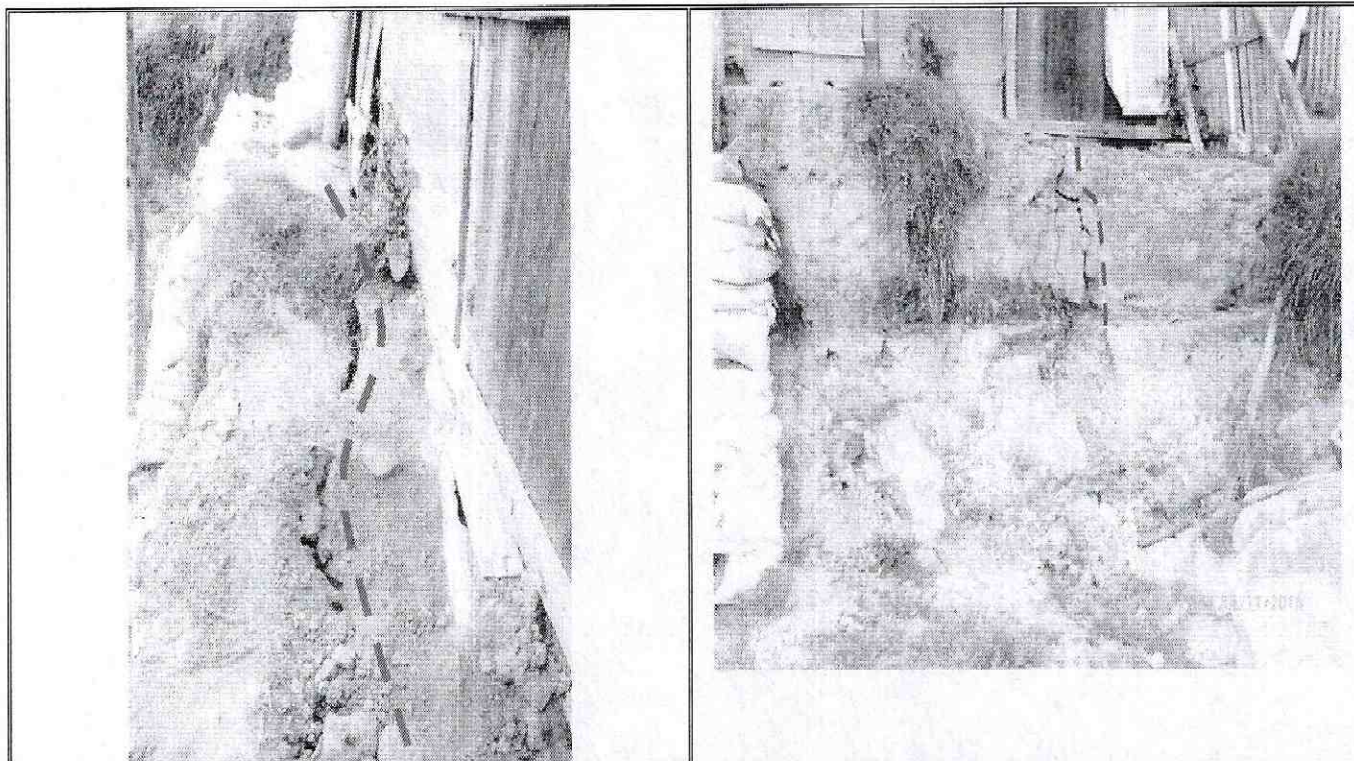
Fotografía 5. Presencia de grietas en el piso del predio de la Calle 70 L No. 22-47 Sur, en el Barrio Los Alpes, en la Localidad de Ciudad Bolívar.
