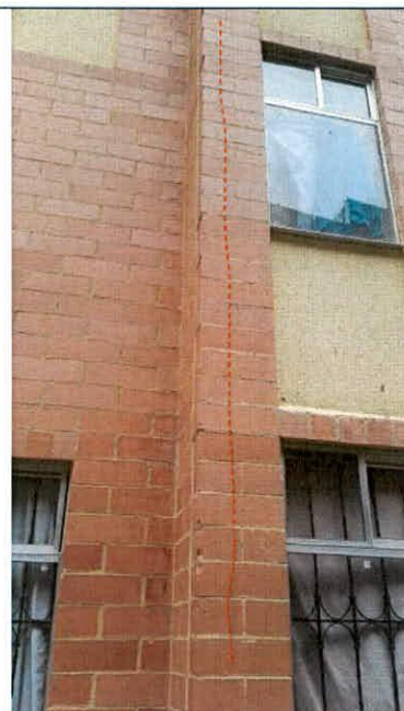
Fotografía 10. Vista de fisura longitudinal en fachada de torre 1.
