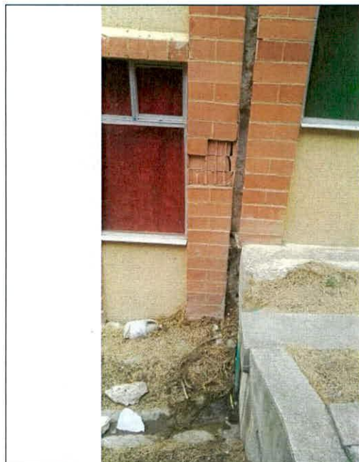
Fotografía 9. Vista de fachada de torres 3 y 4. Grietas y evidencia de caída de mampuestos en el primer nivel. Daño Moderado
