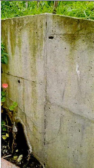
Fotografía 11. Vista de fisura en el muro que delimita el acceso peatonal frente a la Torre 1
