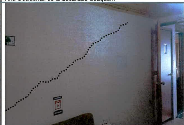
Fotografía 4. Grietas identificadas en muros divisorios y de cerramiento de la zona suroriental de la vivienda ubicada en el predio de la Calle 107 No. 8 A – 41.
