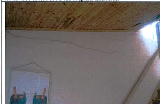
Fotografía 3. Grietas identificadas en muros divisorios y de cerramiento de la zona suroriental de la vivienda ubicada en el predio de la Calle 107 No. 8 A – 41.
