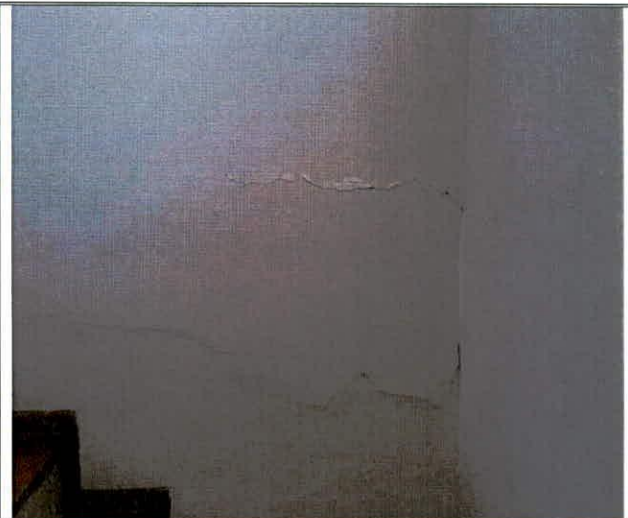
Fotografía 6. Grietas identificadas en muros divisorios y de cerramiento de la zona suroriental de la vivienda ubicada en el predio de la Calle 107 No. 8 A - 41.
