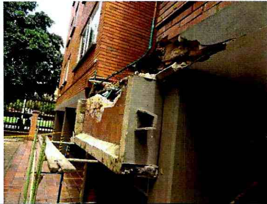
Fotografía 3. Vista daño en voladizo, se encuentran expuestos algunos materiales con probabilidad de caída.
