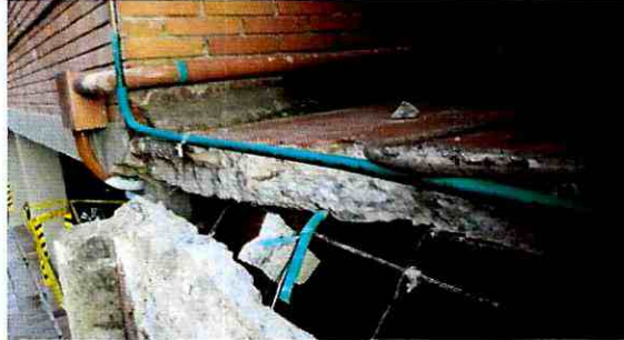
Fotografía 4. Detalle de afectación en voladizo de la entrada al Bloque 5
