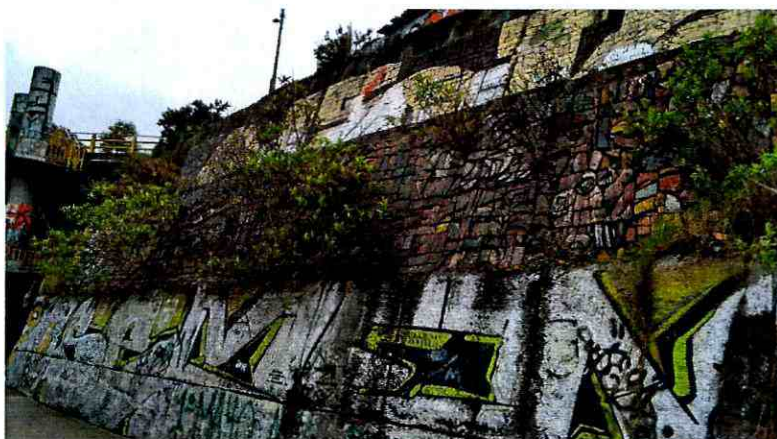
Fotografía 4. Muro de contención de la parte inferior del talud en buenas condiciones (Costado Occidental del puente).
