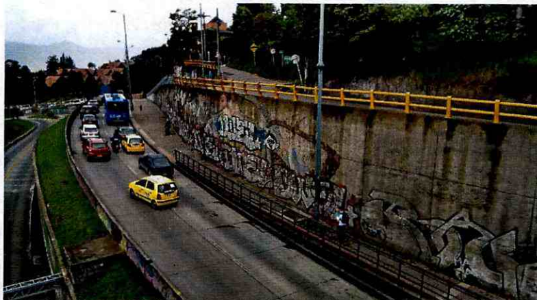
Fotografía 6. Muro de contención de la parte inferior del talud lateral de la vía en estado (Costado Oriental del Puente).
