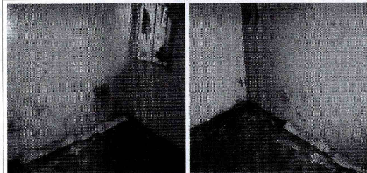
Fotografías 5 y 6 - Afectaciones detectadas en el predio de la Carrera 19 No. 62 B – 14 Sur donde la habitación más afectada ha sido desalojada
