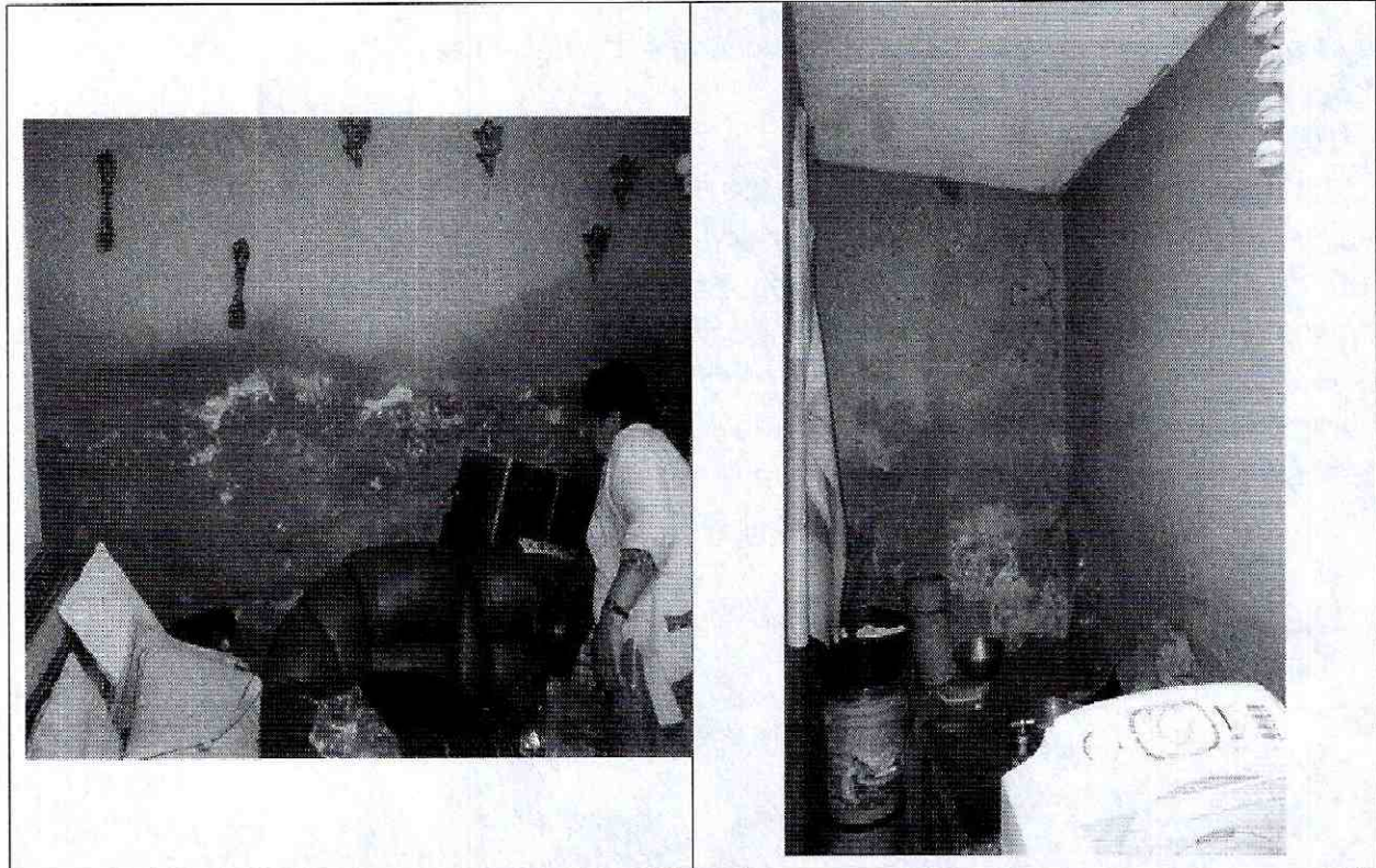
Fotografías 3 y 4 - Afectaciones detectadas en el predio de la Carrera 19 No. 62 B – 04 Sur
