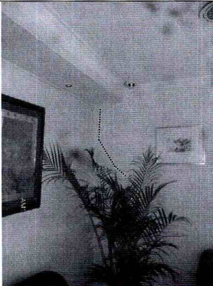
Fotografía 5. Presencia de fisuras en muros de cerramiento de la portería del Conjunto Residencial La Esperanza I y II P.H. de la Calle 163B No. 45 - 32, en el Sector Catastral Britalia de la Localidad Suba.
