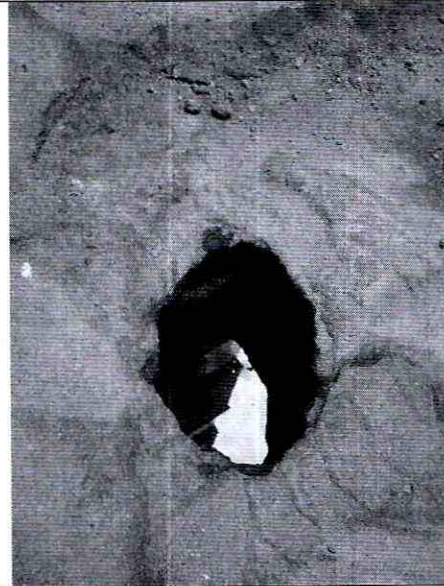
Fotografía 22. Presencia de agua estancada en la zona de estacionamiento del Conjunto Residencial La Esperanza I y II P.H. de la Calle 163B No. 45 - 32, en el Sector Catastral Britalia de la Localidad Suba.
