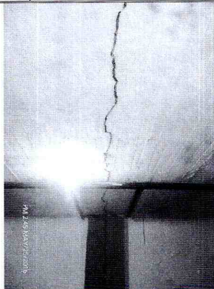
Fotografía 5. Dilatación constructiva de torres en la zona de estacionamiento del Conjunto Residencial Agrupación de Viviendas Escandinavia Norte P.H. de la Calle 147 No. 12 - 87, en el Sector Catastral Caobos Salazar de la Localidad Usaquén.
