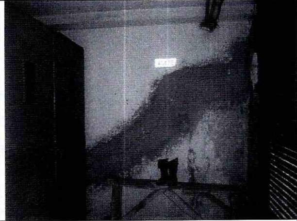
Fotografía 14: Subestación eléctrica – Afectaciones al interior del cuarto donde se localiza la subestación eléctrica.
