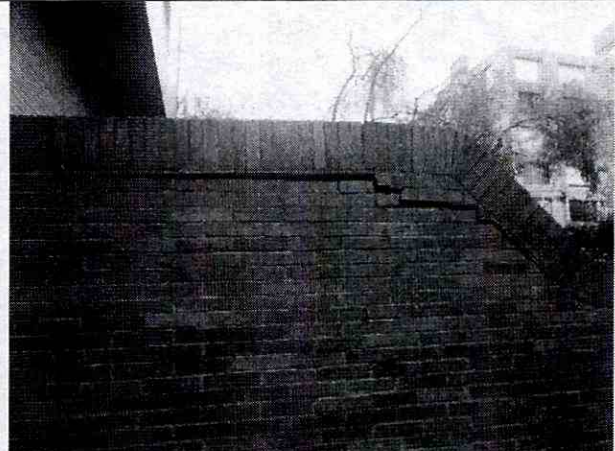
Fotografía 19: Fachada – Afectaciones en la fachada del Edificio Biblos en la entrada a la subestación eléctrica. Según la Administración del predio, estas afectaciones se generaron después del inicio de la construcción del predio Carrera 14 A No. 127 B - 30.
