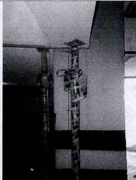
Fotografía 12: Sótano – Para asegurar la estabilidad de las columnas, la constructora encargada de la obra que se realiza en el predio de la Carrera 14 A No. 127 B – 30, ha dispuesto parales junto a estas. Se observa al fondo descascaramientos del concreto de recubrimiento de la columna
