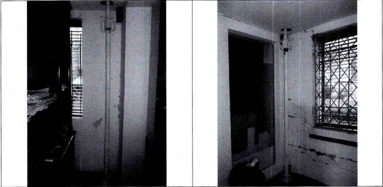
Fotografía 5 y 6: Vista de los parales que a la fecha los encargados de la construcción desarrollada en el predio Carrera 14 A No. 127 B – 30, han emplazado en el apartamento 101 del Edificio Biblos.
