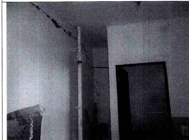
Fotografía 15: Cuarto de bombeo – Afectaciones al interior del cuarto donde se localiza las unidades del bombeo de la edificación. Se observa para dispuesto por la constructora responsable de la obra del predio Carrera 14 A No. 127 B – 30.
