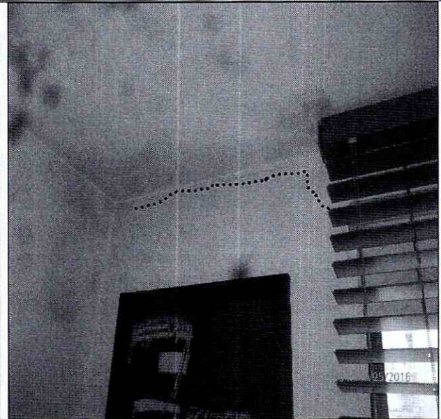
Fotografía 6. Fisuras en muros de cerramiento y divisorios en las viviendas 29 y 30 del conjunto residencial Plazuelas de Iberia 2, en el Sector Catastral Prado Veraniego Norte de la Localidad Suba.
