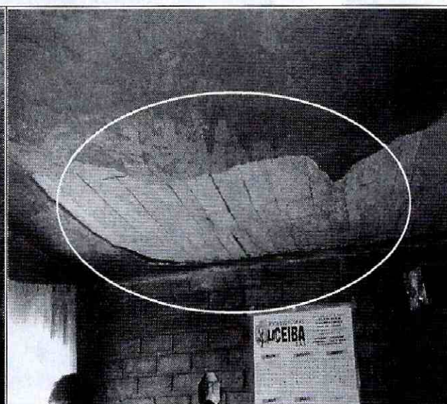
Foto 6. Vista de la placa segundo nivel (costado oriental) de la vivienda evaluada, donde se evidencia desprendimiento de mortero, afectación que no compromete la estabilidad estructural y habitabilidad de la misma en la actualidad.
