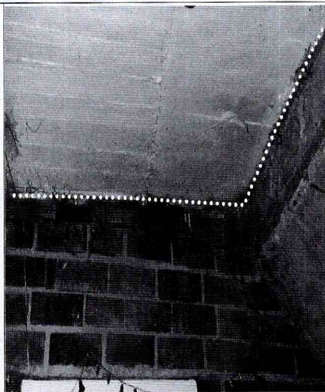
Foto 4. Vista de la placa de entrepiso en la que se observa una fisura de tendencia longitudinal, afectación que no compromete la estabilidad estructural y habitabilidad de la misma en la actualidad.
