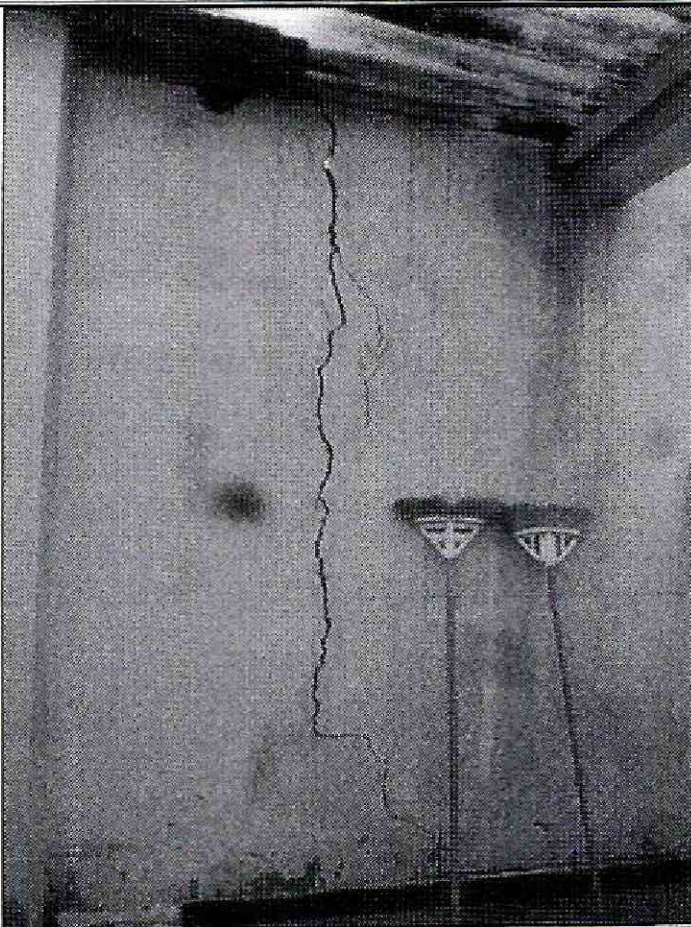
Fotografía 9. Grietas de tendencia vertical en muro de cerramiento del costado norte de la vivienda ubicada en el predio de la Calle 84 No. 21 – 26, en el Sector Catastral Polo Club de la Localidad Barrios Unidos.
