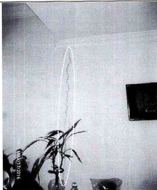
Fotografía 3. Presencia de grietas, fisuras y fracturas en muros de la parte posterior de la vivienda de la Carrera 91 No. 70B - 10 en el Sector Catastral Los Álamos de la Localidad Engativá
