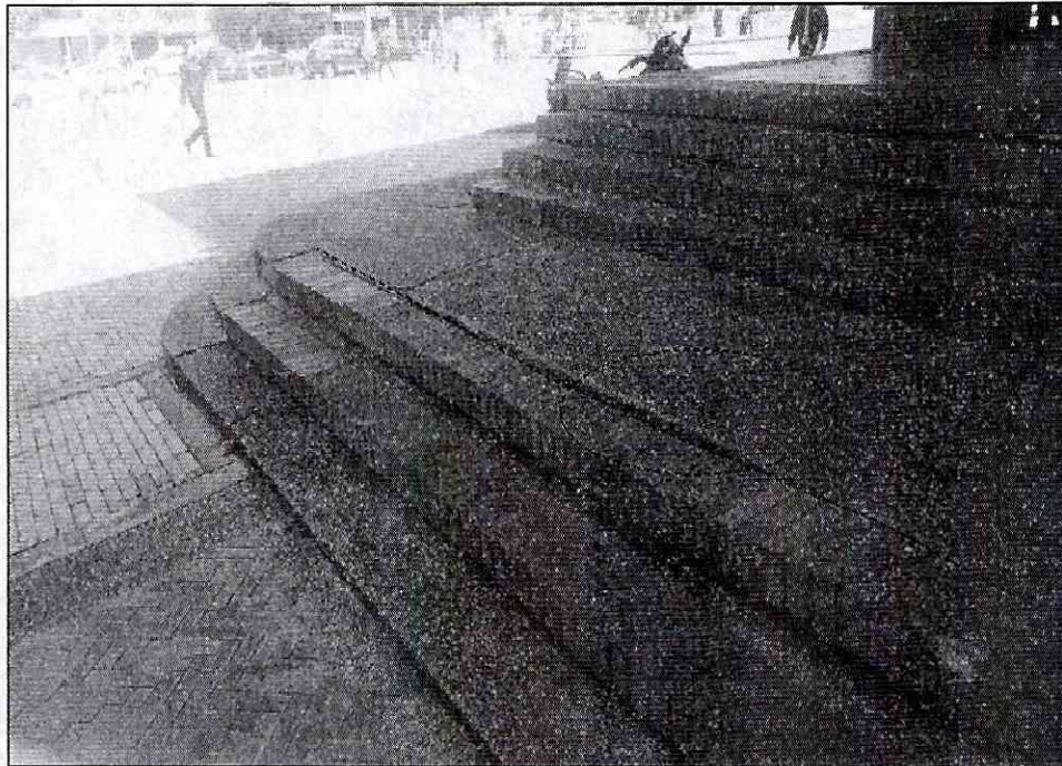
Fotografía 6. Vista de las deformaciones en escalones de acceso a la Clínica Almirante Colón, emplazada en la Carrera 16 No. 84 A – 09 en el Sector Catastral Antigo Country, de la Localidad de Chapinero
