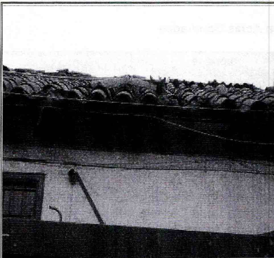
Foto No. 11. Desprendimiento de tejas de la estructura de cubierta de "La Casona"
