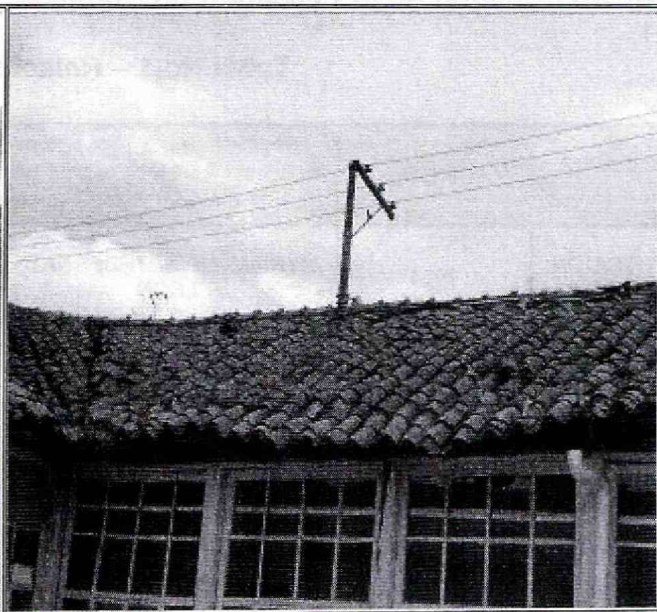
Foto No. 12. Hundimiento de la estructura de cubierta de "La Casona"
