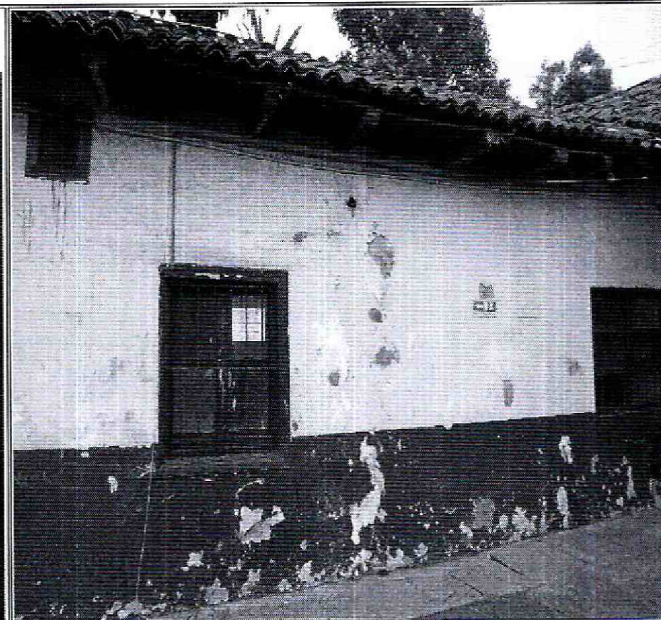
Foto No. 6. Humedades y desprendimientos de pañete muros de "La Casona"
