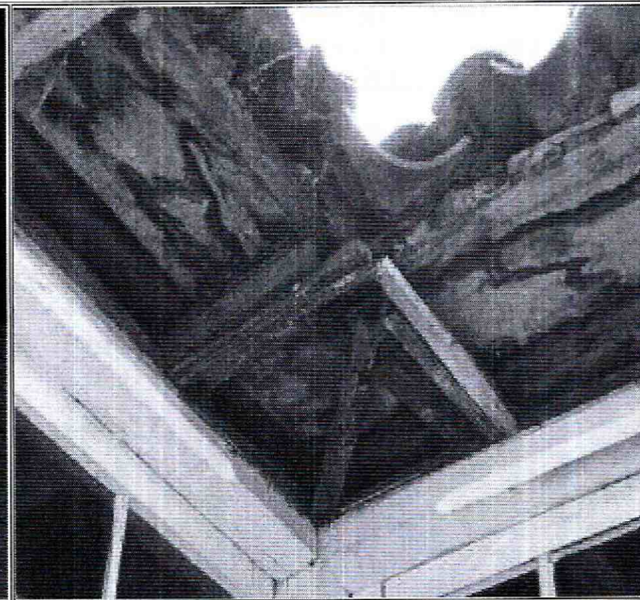
Foto No. 8. Deterioro elementos de madera que componen la estructura de cubierta de "La Casona"
