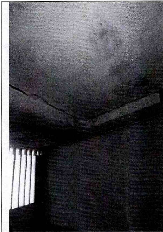
FOTOGRAFIA No 5. Placa de entrepiso del costado suroccidental del predio de la Calle 60 No. 30 – 11, costado suroccidental. Se observa la presencia de humedad y deterioro.
