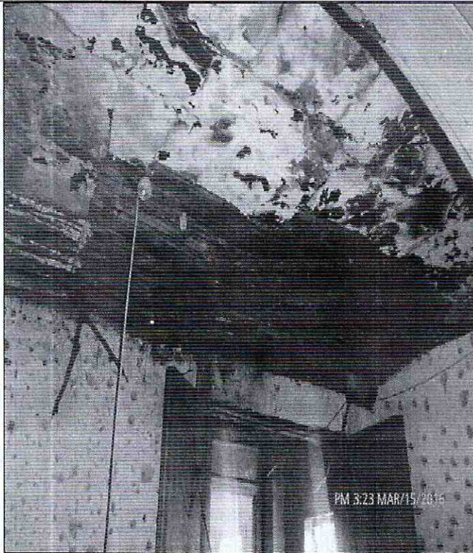
Fotografía 5. Deterioro y pérdida de cielo raso de la edificación del predio de la Carrera 58 No. 71 - 64 en el Sector Catastral San Fernando de la Localidad Barrios Unidos.
