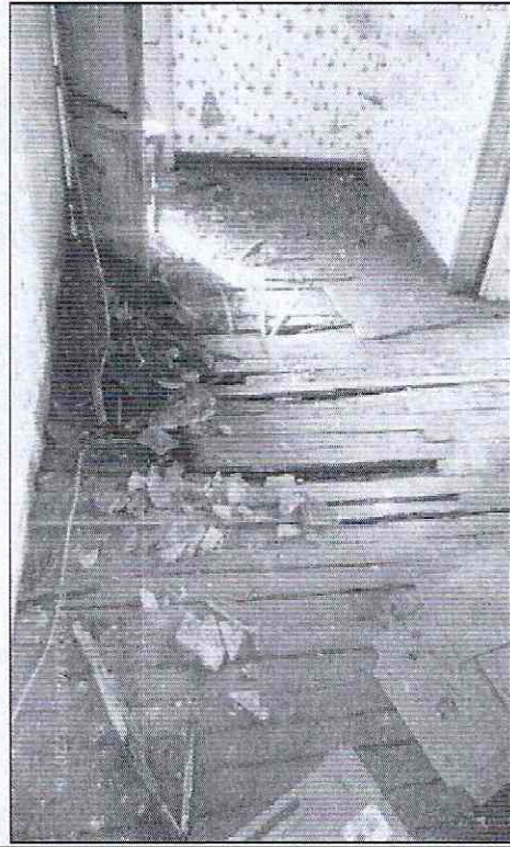
Fotografía 4. Deterioro de la listonería que conforma en entrepiso de la edificación del predio de la Carrera 58 No. 71 - 64 en el Sector Catastral San Fernando de la Localidad Barrios Unidos.
