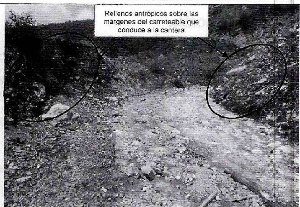
Fotografía 4. Rellenos antrópicos sobre las márgenes del acceso a la cantera, fácilmente transportados por la escorrentía.
