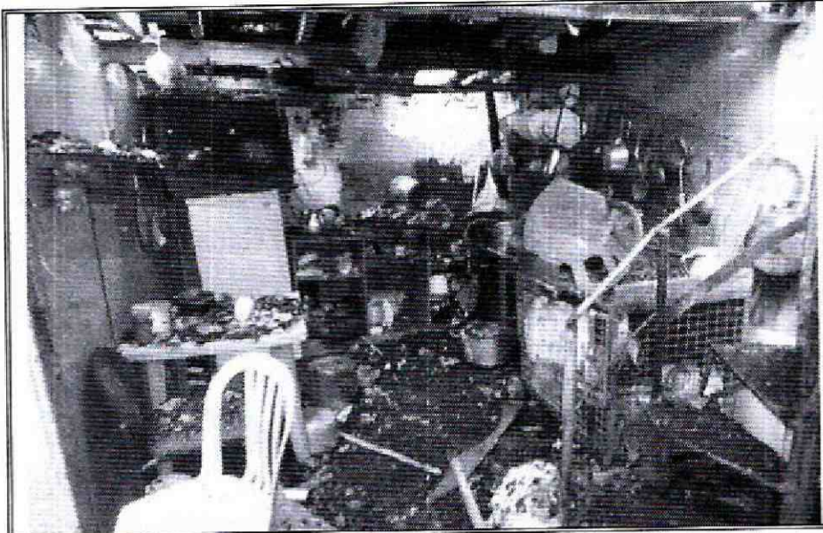
Foto No. 3. Afectación de la cocina, en la vivienda de la Carrera 57 No. 17-95.
