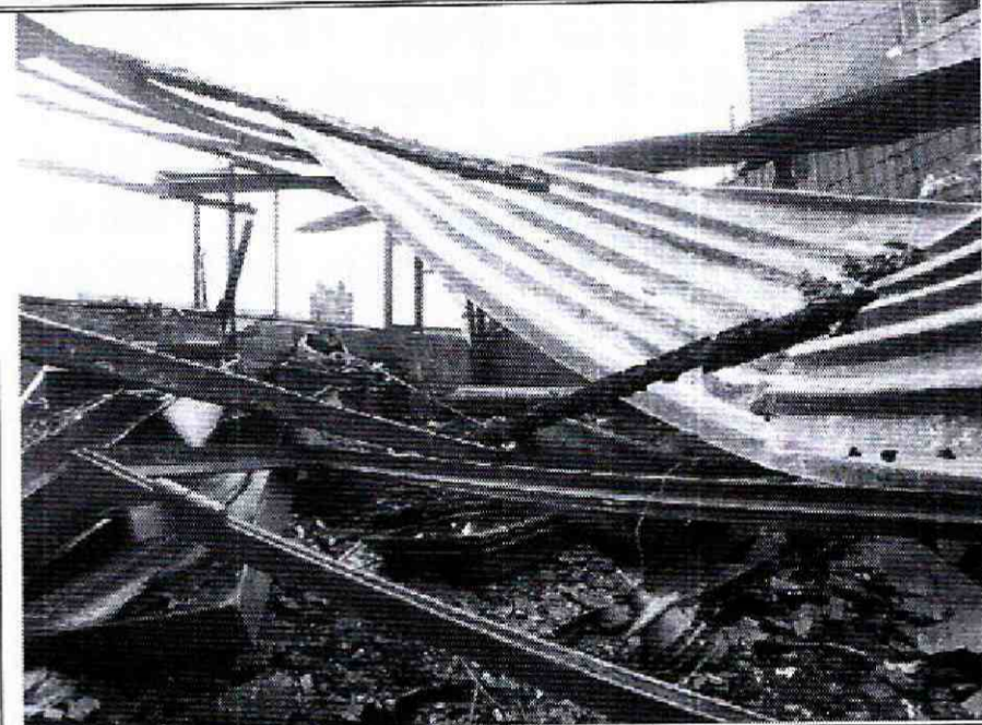
Foto No. 5. Afectación de las alcobas del segundo nivel y cubierta, en la vivienda de la Carrera 57 No. 17-95.
