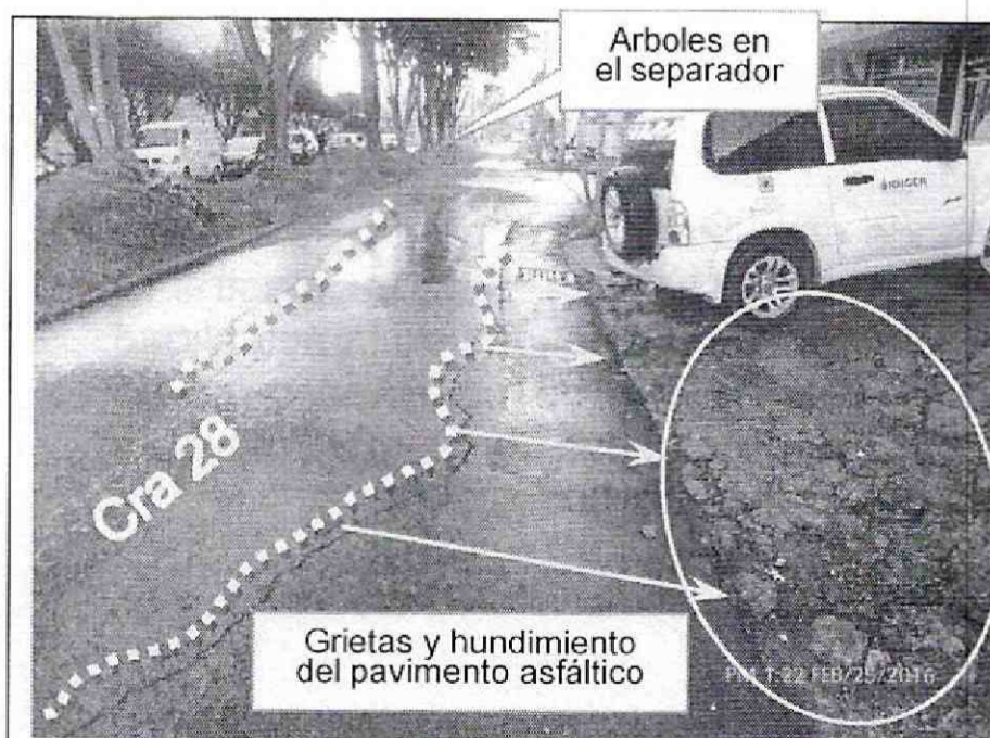
Fotografía 8. Vista de los hundimientos evidenciados sobre la Carrera 28 aledaños al predio evaluado. Se observan grietas longitudinales en el eje de la vía y carril del costado oriental y colapso de las losas que conforman el andén.
