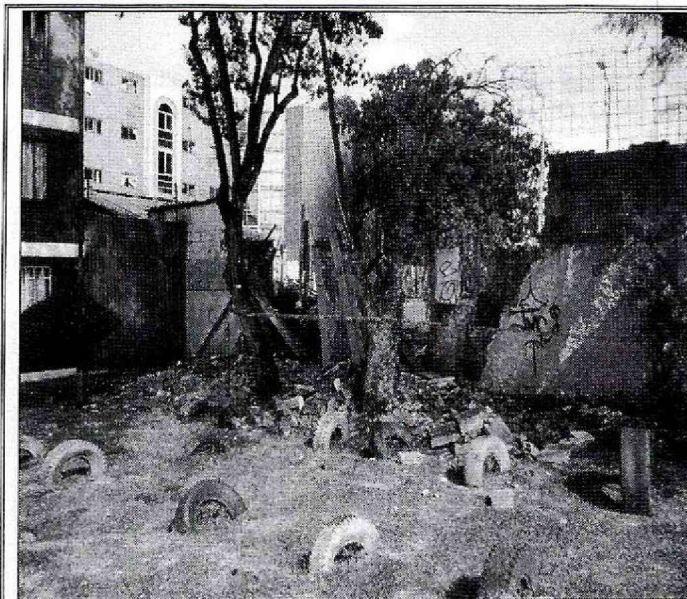
Fotografía 1. Vista del colapso del muro de cerramiento ubicado a la altura de la Calle 137 con Carrera 94 D en el Sector Catastral Villa Elisa de la Localidad Suba. Se observan algunos individuos arbóreos en cercanías al muro.
