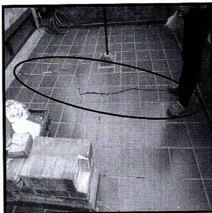
Fotografías 7. Grieta de tendencia longitudinal en el acabado del contrapiso del antejardín en la casa 27, en el Conjunto Residencial Mallorca II Primera Etapa, en el Sector Modelia Occidental, de la Localidad de Fontibón
