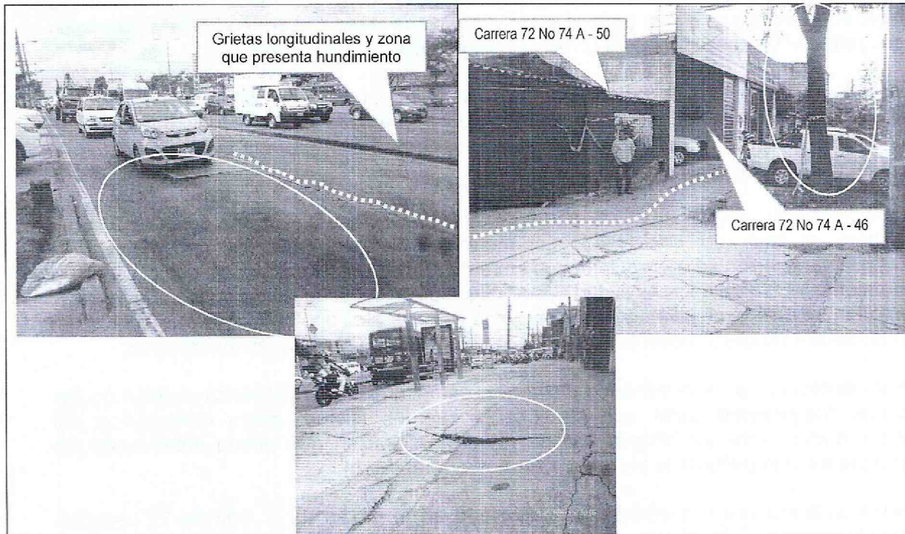
Fotografía 1, 2 y 3. Vista de las afectaciones evidenciadas en la Avenida Boyacá con Calle 74 A, manifestadas en grietas longitudinales y hundimiento de la calzada. Además colapso parcial de algunas placas de concreto que conforman el andén frente al predio de la Carrera 72 No 74 A - 50
