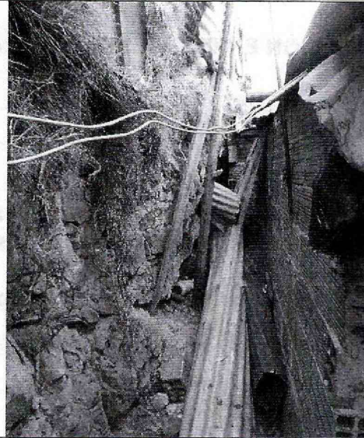
Foto No. 4. Talud de corte sobre el costado occidental de la vivienda evaluada.
