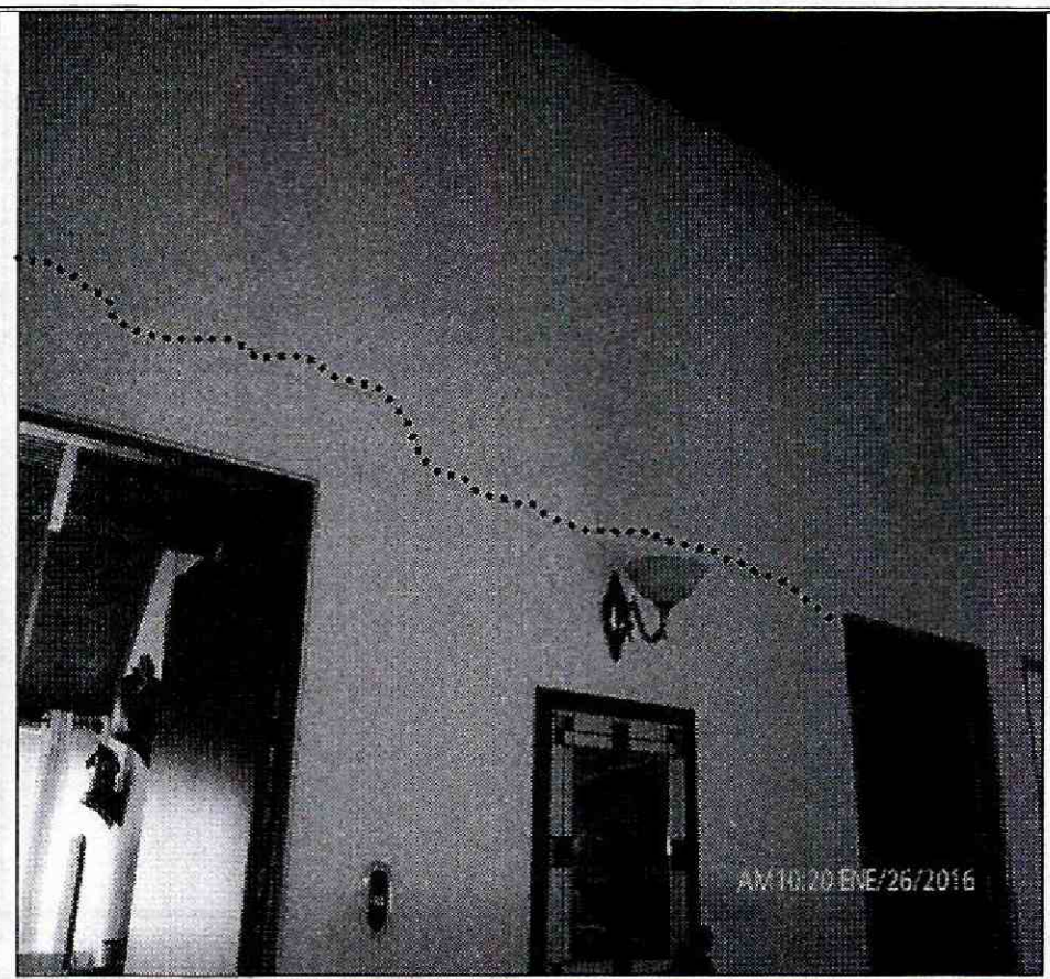
Fotografía 2. Fisura de tendencia horizontal en muros divisorios del segundo nivel de la zona frontal de la vivienda de la Carrera 70 A No. 123 - 03 en el Sector Catastral Niza Sur de la Localidad Suba.
