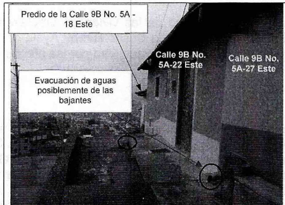
Fotografía 7. Tuberías frente a las viviendas de la Calle 9B No. 5A-22 Este y Calle 9B No. 5A-27 Este, drenan al respaldo bordillo y terminan frente a la vivienda de la Calle 9 No. 5A-18 Este.
