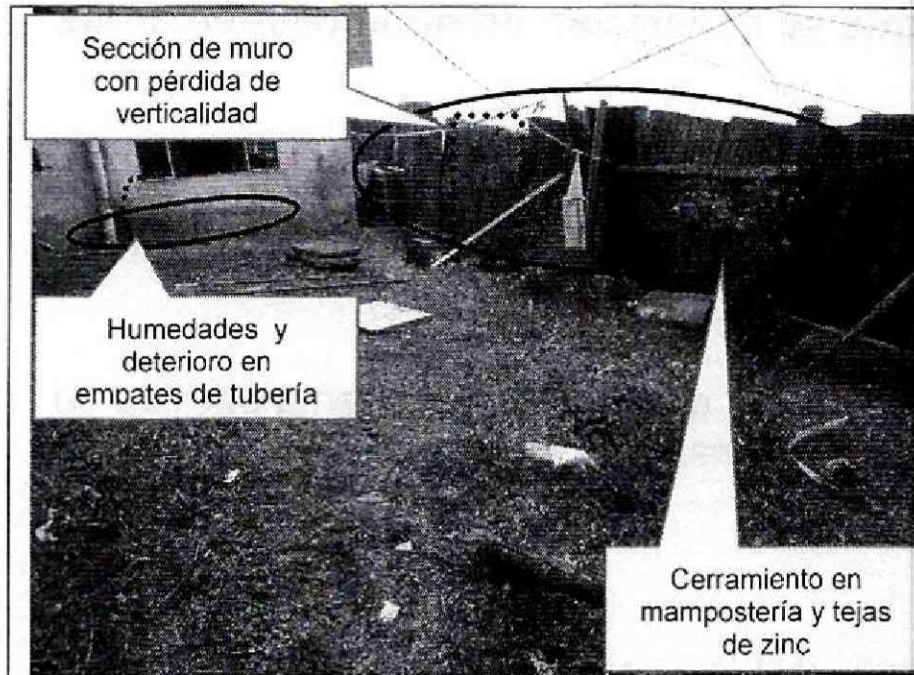
Fotografía 5. Cerramiento en mampostería simple (ladrillo y bloque) y láminas de zinc y sección de muro con pérdida de verticalidad.
