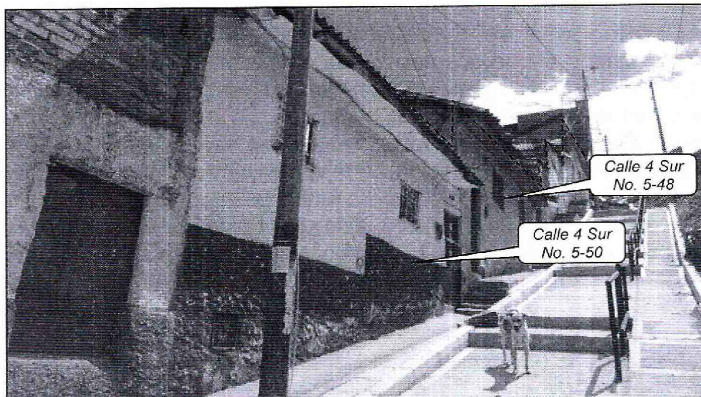
Fotografía 1. Vista de la acomodación escalonada de las viviendas emplazadas en el predio de la Calle 4 Sur No. 5-50 y Calle 4 Sur No. 5-48, en el Barrio Las Brisas, de la Localidad de San Cristóbal, donde se observa así mismo la falta de junta de dilatación
