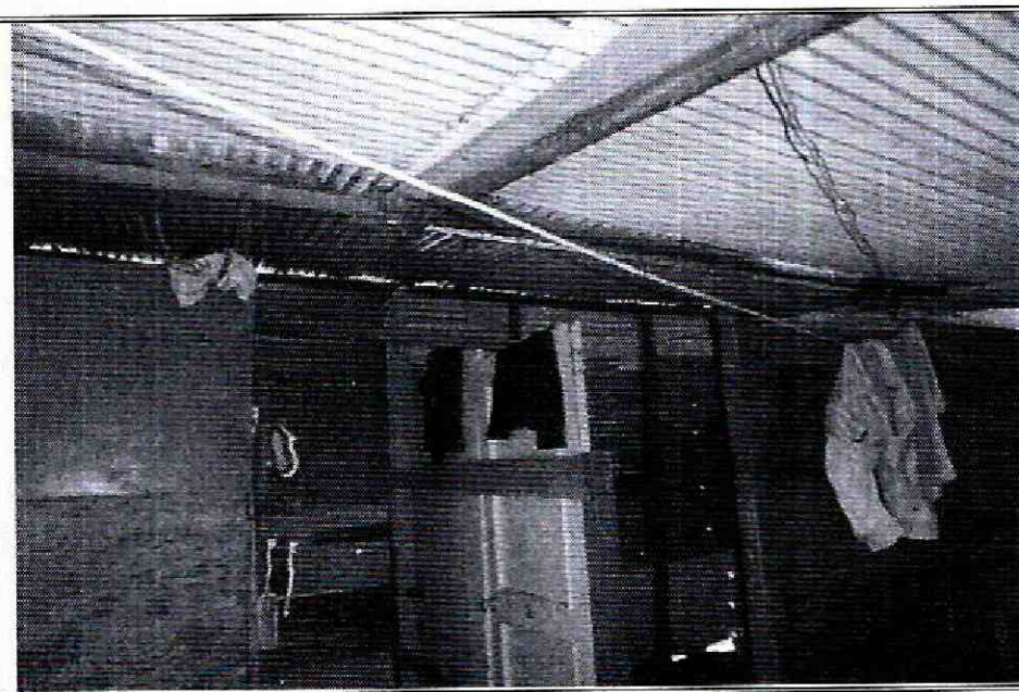
Foto No. 2. Sostenimiento de la cubierta con entramado en madera en la vivienda de la Calle 70 M Sur No. 19F-30.
