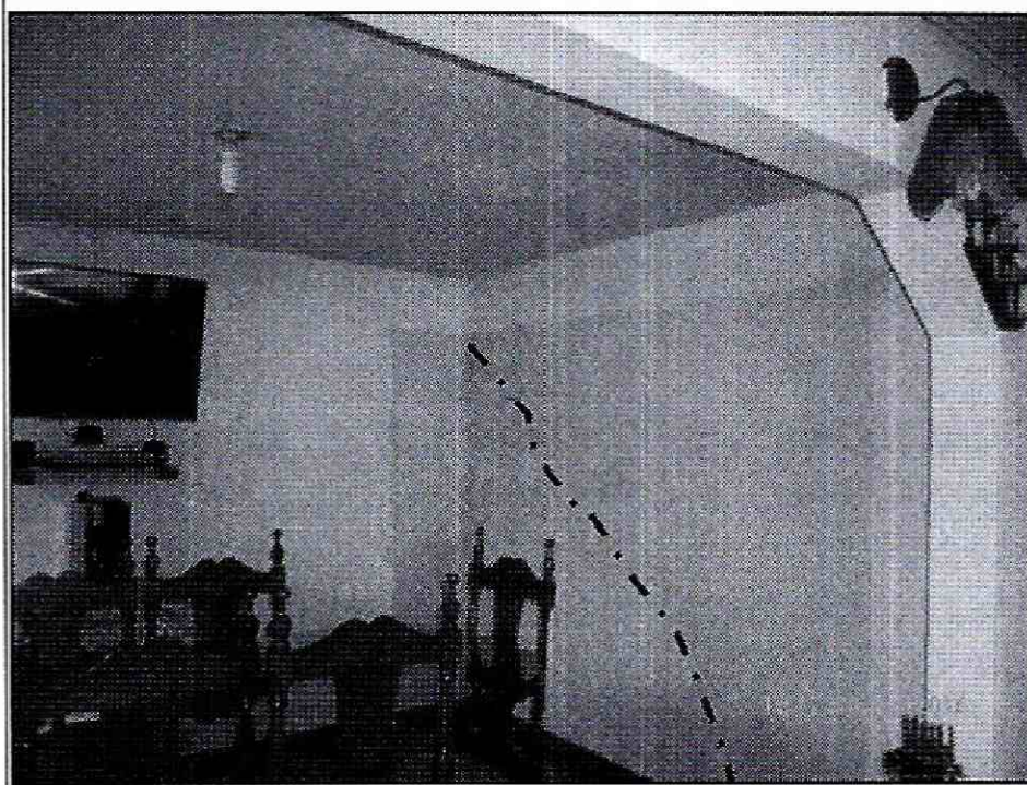
Foto 3. Vista del muro divisorio del primer nivel (costado oriental) de la vivienda evaluada, en el cual se identifica una fisura de tendencia diagonal, afectación que no compromete la estabilidad estructural y habitabilidad de la misma en la actualidad.
