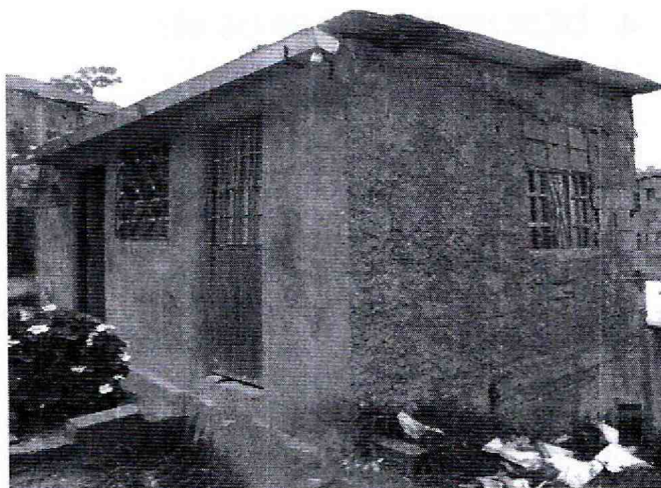
Fotografía 2. Aspecto de la vivienda emplazada en la Dg. 18 P Sur No. 69R-09, en el Barrio Villas del Diamante de la Localidad de Ciudad Bolívar
