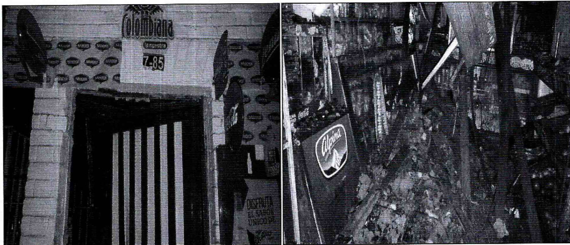
Fotografía 13 y 14. Vista de las afectaciones en cielo raso y cubiertas livianas al interior de la vivienda Calle 6A No. 7-85 del Sector Catastral Santa Bárbara Localidad de La Candelaria
