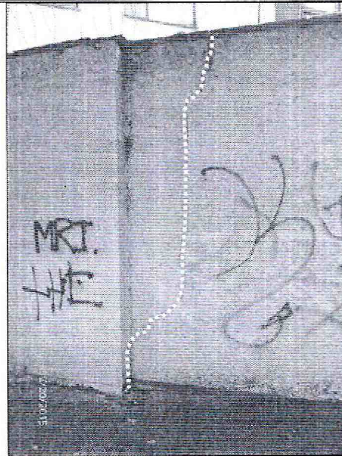
Fotografía 4. Fisuras de tendencia vertical identificadas en el muro de cerramiento del costado oriental del conjunto residencial Escocia, ubicado en el predio de la Calle 100 No. 49-85, en el Sector Catastral la Castellana de la Localidad de Barrios Unidos.
