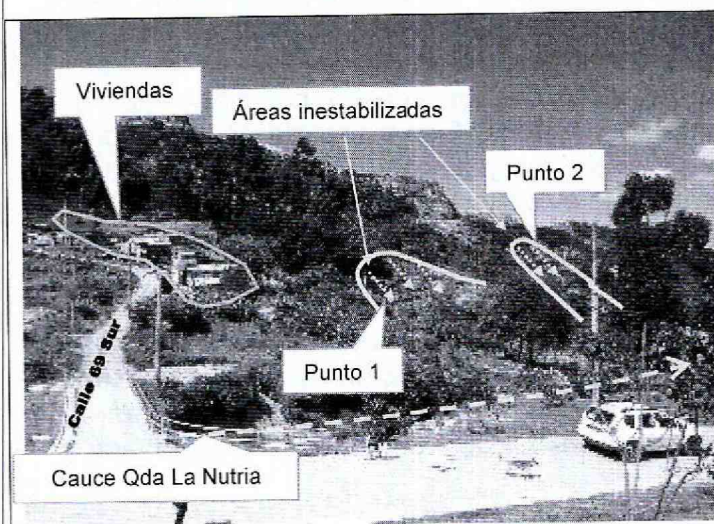
Fotografía 1. Vista de las áreas inestabilizadas en inmediaciones de la Quebrada La Nutria, Puntos 1 y 2, en el Parque Distrital Entrenubes, que ya cuentan con algunas medidas de protección y estabilización.
