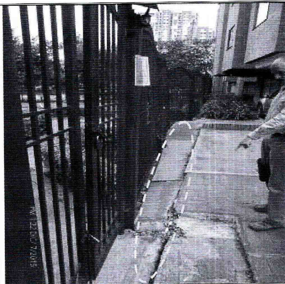
Fotografía 2. Fisuras y hundimientos en los elementos no estructurales Conjunto Residencial Oikos ubicado en el predio de la Carrera 56 A No. 137 – 74
