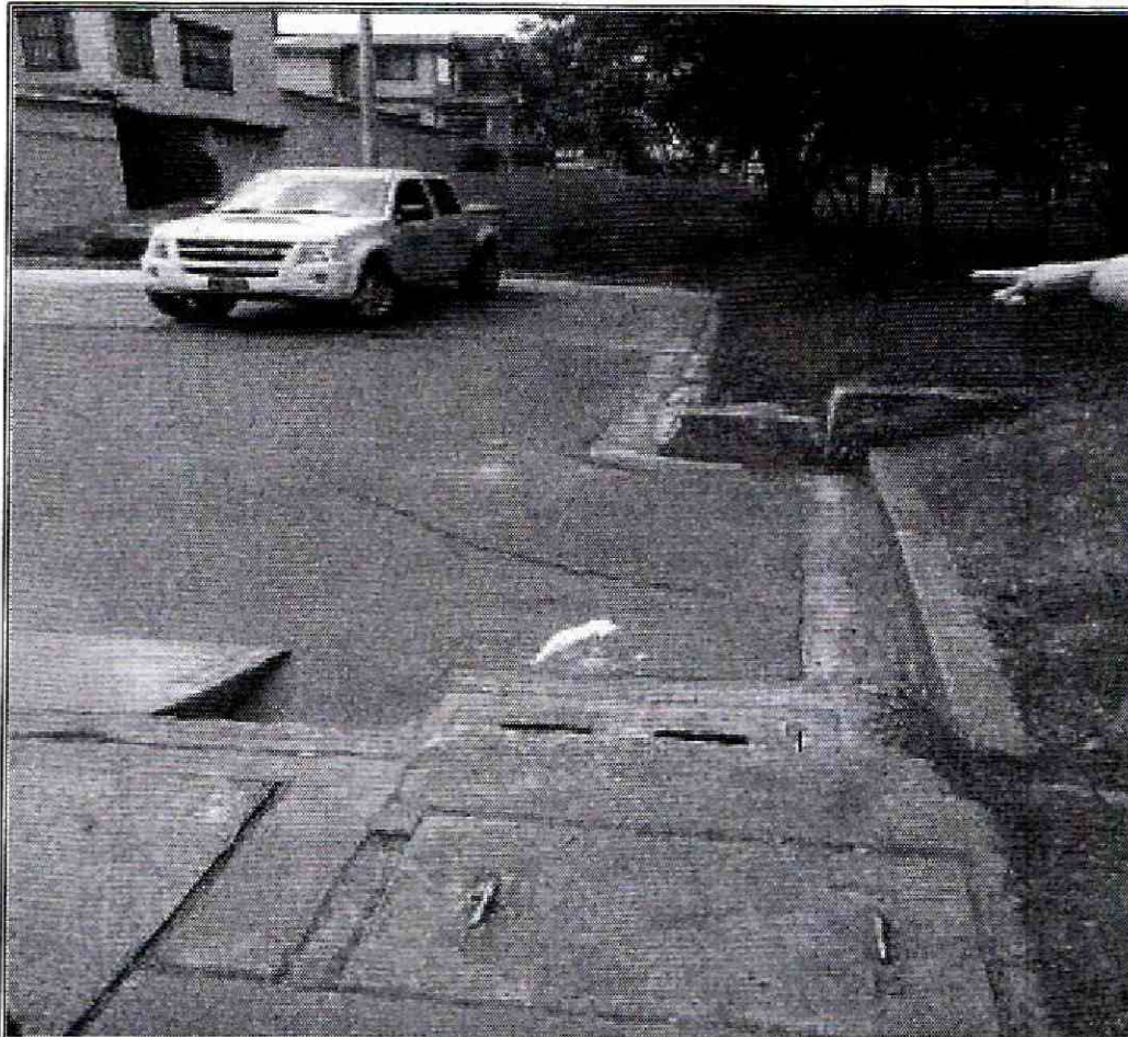
Fotografía 5. Grietas de tendencia curva, hundimiento en sardineles, cajas de inspección y bordillos en la parte perimetral costado occidente del conjunto residencial Oikos.
