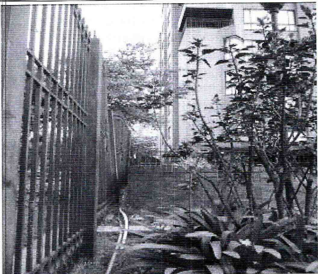
Fotografía 3. Perdida de verticalidad de los elementos que conforman la estructura de cerramiento perimetral
