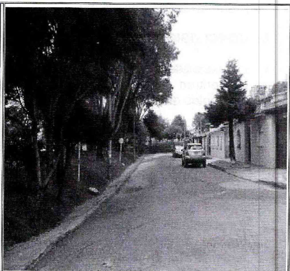
Fotografía 6. Hundimiento de la vía colindante a la zona verde aledaña al Conjunto Residencial Oikos
