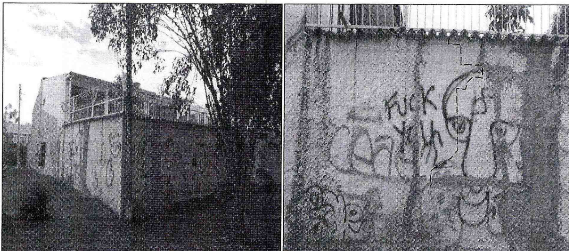
Fotografía 2 y 3. Fachada posterior de la vivienda emplazada en el predio de la Calle 121 No. 70 F – 70, en el Sector Catastral Niza, de la Localidad de Suba, donde se presentan grietas escalonadas en el muro de cerramiento de patio.
