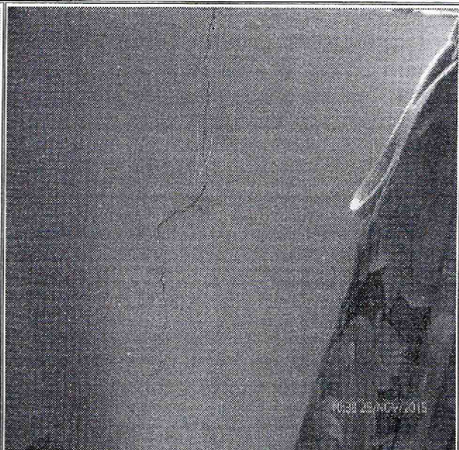
Foto No. 8. Fisura tendencia vertical habitación segundo nivel de la vivienda
