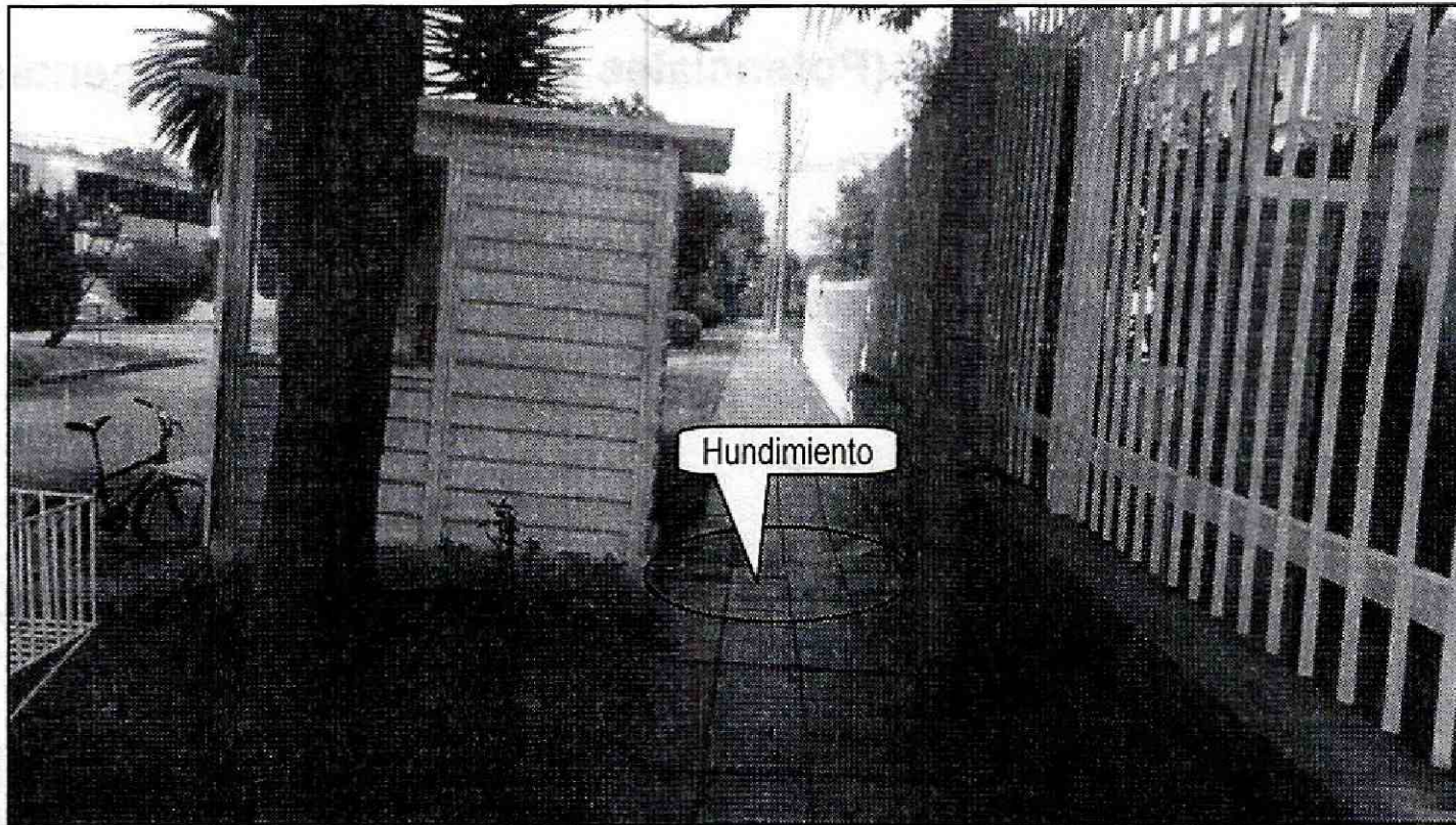
Fotografía 5. Vista del hundimiento en el andén sobre la Calle 119A colindante con la vivienda ubicada en el predio de la Calle 119 A No. 70 G - 18, en el Sector Catastral Niza, de la Localidad de Suba
