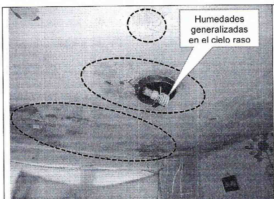
Fotografía 5. Humedades generalizadas en el recubrimiento del cielo habitación del costado sur en la vivienda de la Carrera 5A Bis Este No. 9B-09
