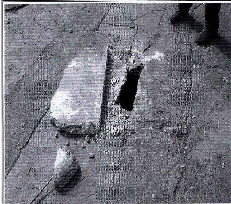
Foto No. 3. Fractura estructura del andén
