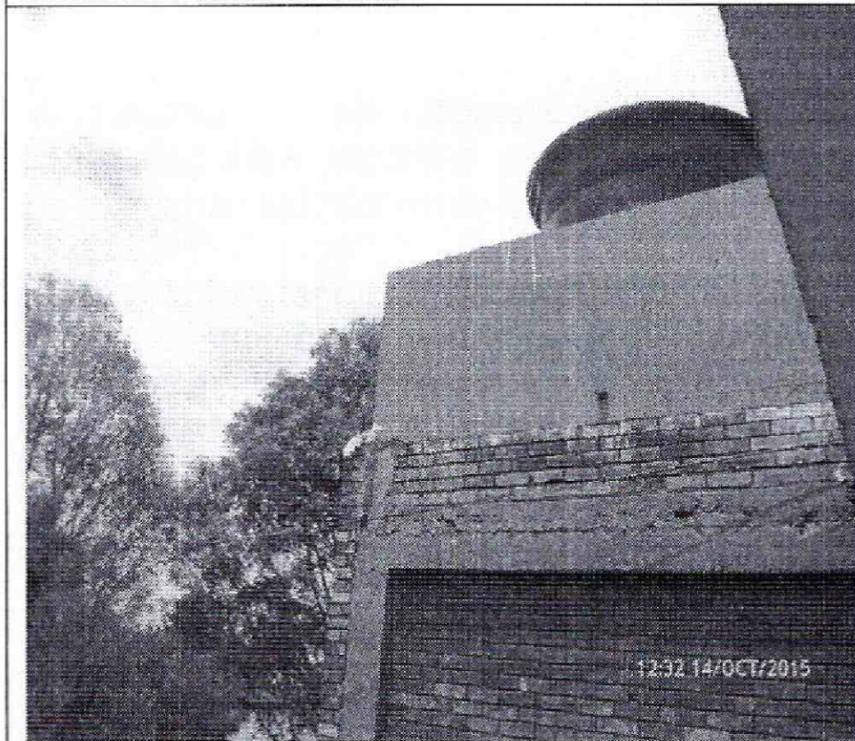
Fotografía 3: Se observa el tanque de almacenamiento ubicados en la cubierta del Bloque 7 Entrada 21, la Unidad Residencial Súper manzana 2, en el predio de la Carrera 73 B Bis N° 26 – 81 Sur.
